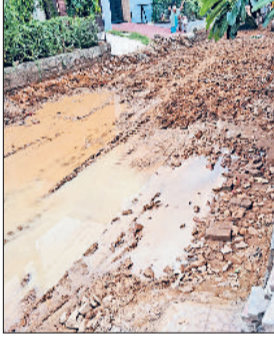
भिवानी। सेक्टर 23 के मार्केट वाले मुख्य मार्ग के नवनिर्माण के दौरान सीवरेज व पानी की लाइन टूटने से भरा पानी। फोटो: हरिभूमि
